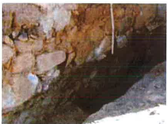
Fig. 3.22. Fasi di risanamento delle fondazioni, scavo di ispezione sino alla quota di posa del basamento.
