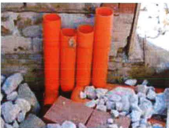
Fig. 3.21. Sistema di aerazione del vespaio: raccordo tra le canalizzazioni orizzontali e verticali viste dall'interno dell'edificio durante la realizzazione.
